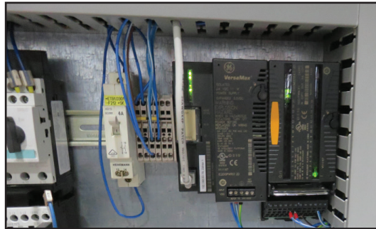
Aufnahme der Flaschenzähler mit schnellen EA-Zählermodulen der GE VersaMax*.
